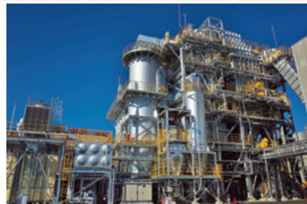
バイオマス発電プラント
