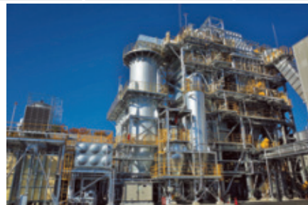
バイオマス発電プラント
